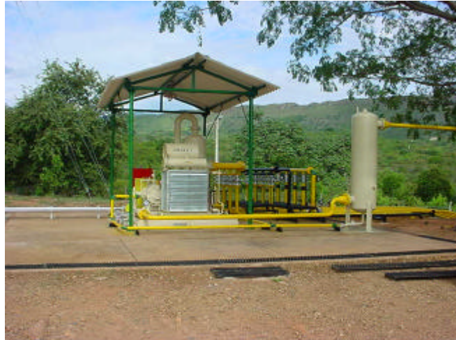
Figura 11. Vista general de un compresor recolectando gas de varios pozos.
