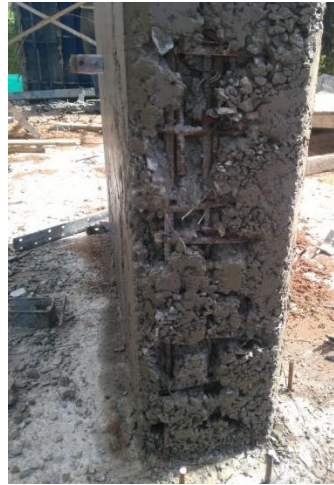
Figura 10. Columna "hormigueada" por la mala vibración del concreto a la hora de fundir.
