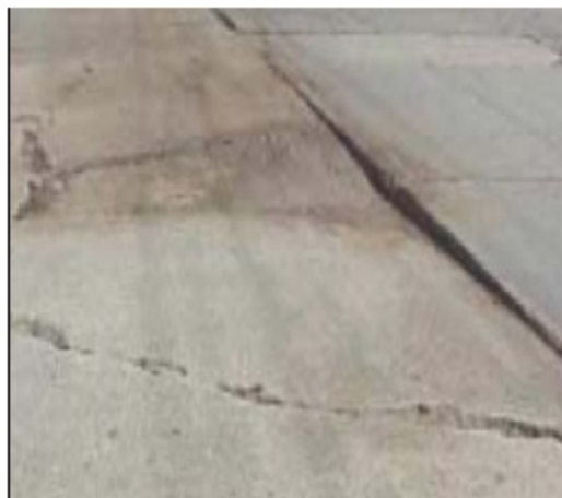
Figura 69. Hundimientos o asentamientos
