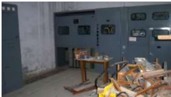
Figura 72 Vista General Subestación Eléctrica.
