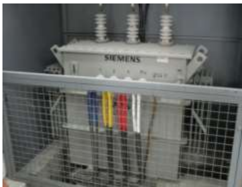
Figura 12 Transformador sede UIS Barrancabermeja.
