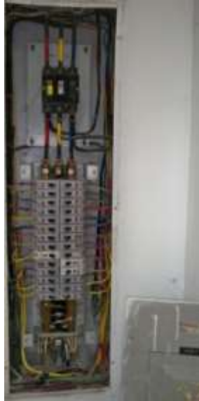
Figura 15 Barraje Tablero TA
