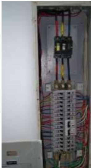
Figura 29 Barraje Tablero TK.
