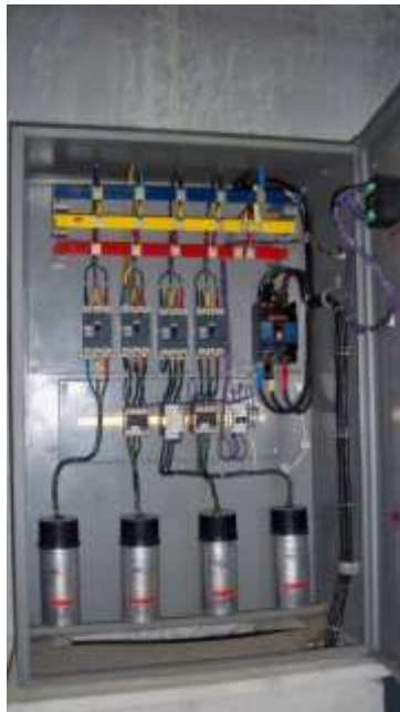
Figura 14 Tablero de compensación.
