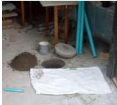
Figura 53 Ubicación cámara de inspección electrodo malla de puesta a tierra Subestación
