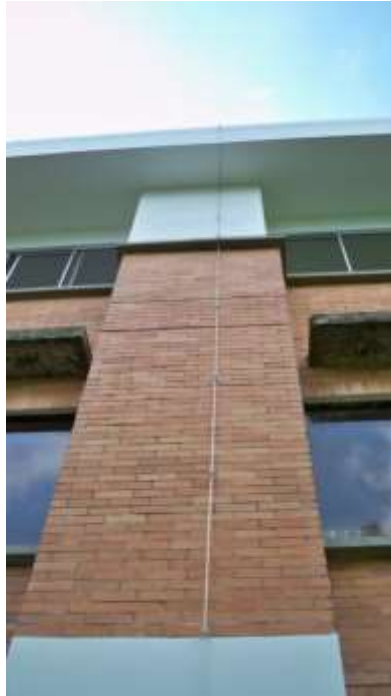
Figura 64 Conductores bajantes del SIPRA
