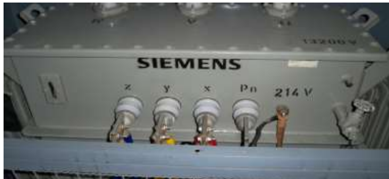
Figura 13 Tierra conectada con el neutro en bornes del transformador.
