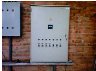
Fotografía 13. Tablero electrónico para la Medición del Agua Tratada
