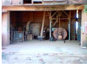
Fotografía 3. Molino de Bolas y Horno instalados en la Planta
