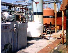
Fotografía 6. Sección 103: Planta de Suavización y Desmineralización.
