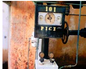
Fotografía 12. Instrumentación neumática (Controlador indicador de Presión)
