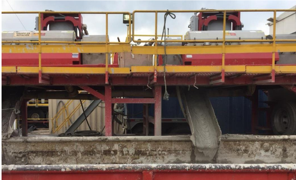
Figura 11. Centrifugas pozo RIG-118
