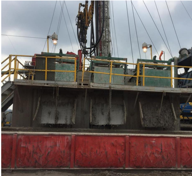
Figura 9. Zarandas Vibratorias Pozo RIG-118
