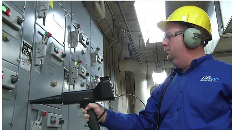
Figura 18. Monitoreo por ultrasonido en tablero eléctrico.
