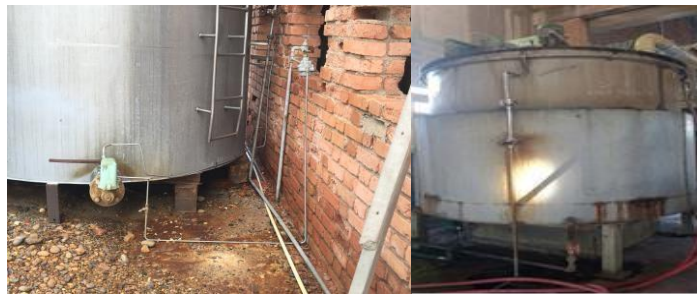
Figura 10. Válvula del tanque de almacenamiento de ácido Nítrico \text{HNO}_3 y Tanque reactor. Adaptado de Fertilizantes Colombianos S.A
