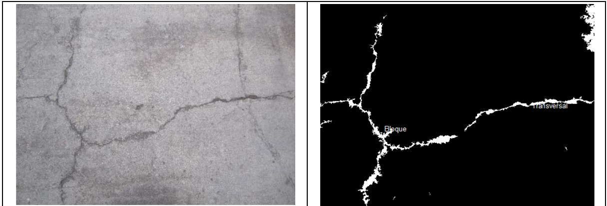
Figura 42. Fisura de bloque y transversal.
