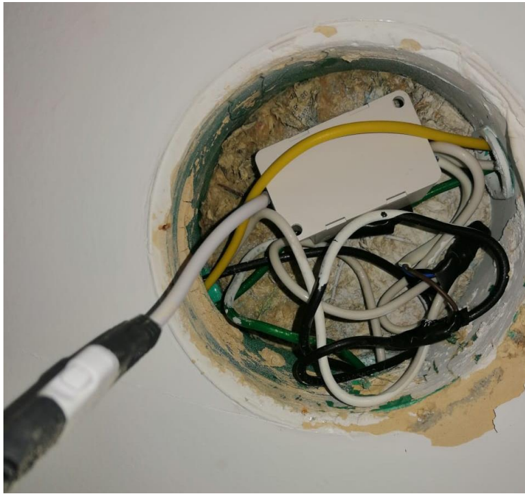
Figura 12. Cableado de iluminación según especificaciones del RETIE (Foto tomada en la práctica empresarial).
