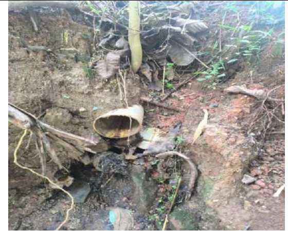
Fotografía 8: Tubería de descarga de ARD
