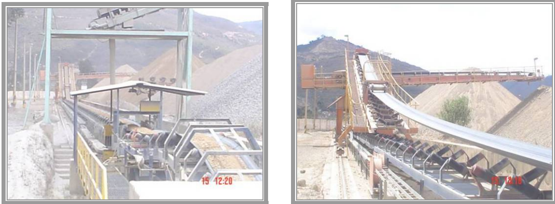
Figura 42. Banda 16112 y apilador a repotenciar
