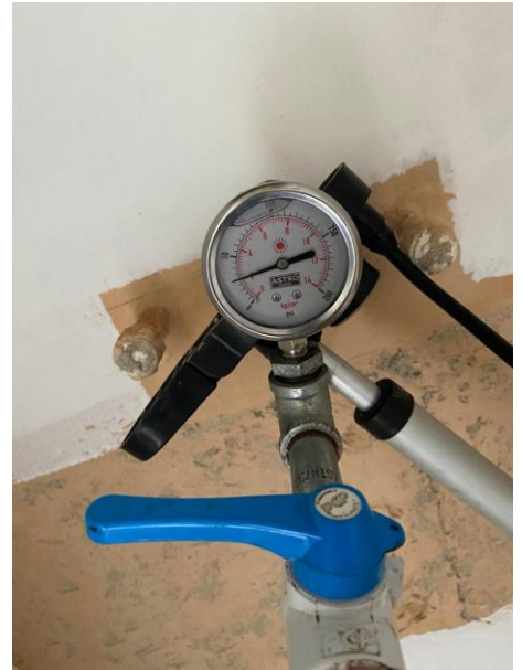
Ilustración 5 Manómetro para Pruebas Hidráulicas
