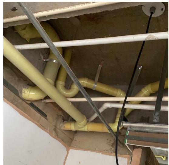
Ilustración 6 Arañas Sanitarias de Cocina Apto 302
