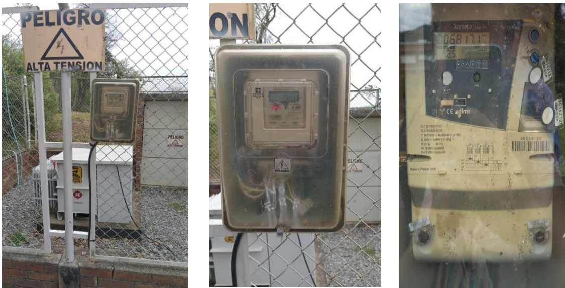
Figura 17. Medidor electrónico instalado en la universidad
