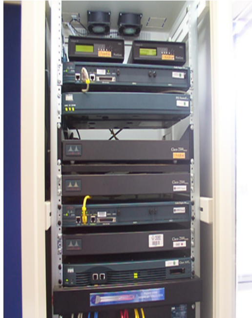
Figura 2. Equipos pertenecientes a UNIRED ubicados en el rack del proveedor
