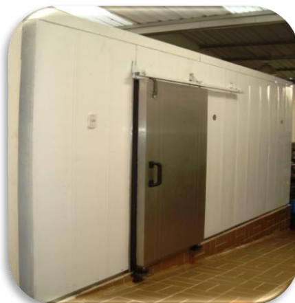
Fotografía D7. Cuarto frío
