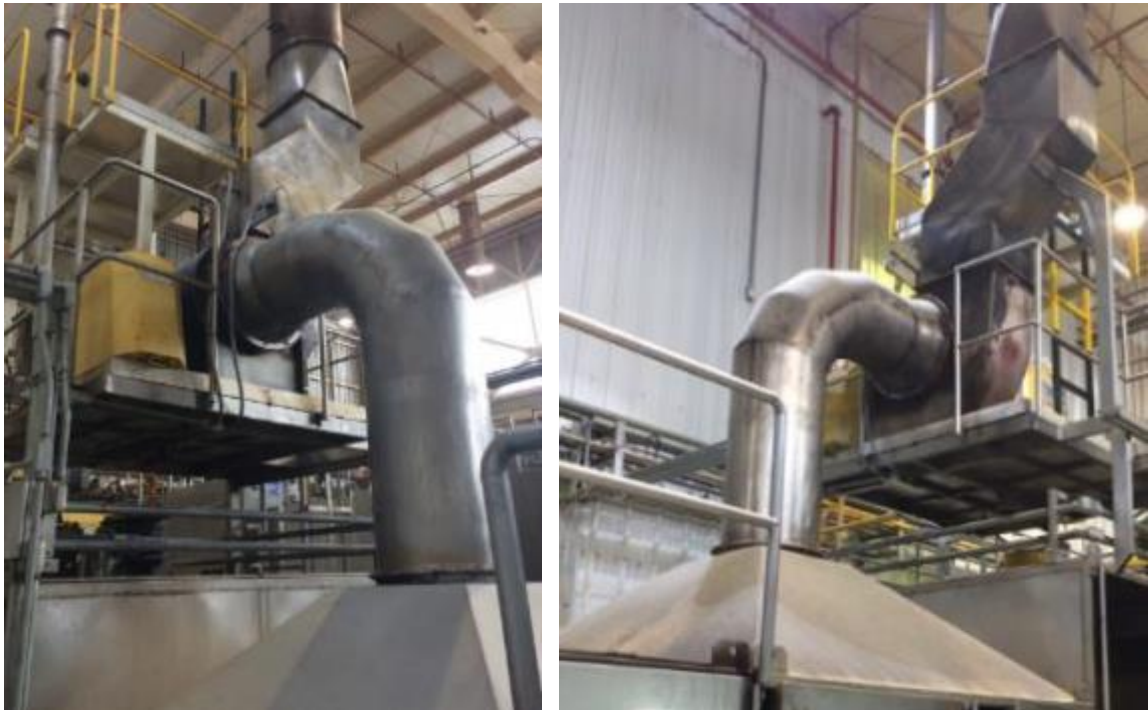
Figura 52. Imagen ventilador sistema de refrigeración.
