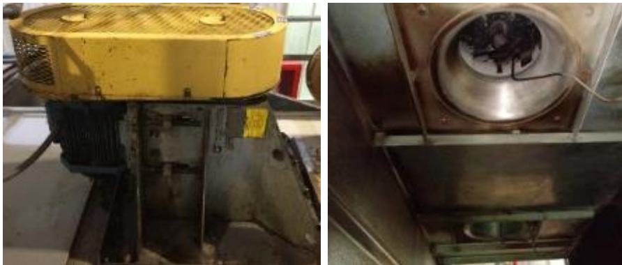
Figura 50. Imagen ventilador recirculación aire caliente.
