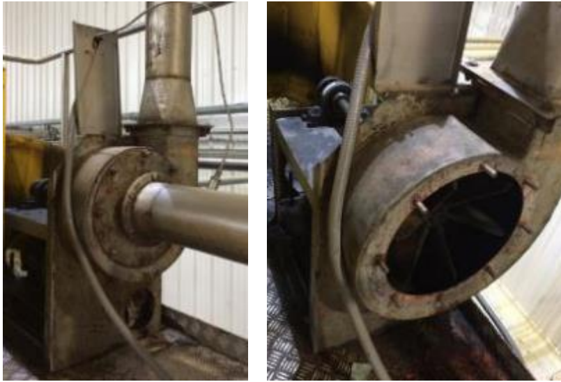
Figura 48. Imagen del sistema de extractor aire húmedo.
