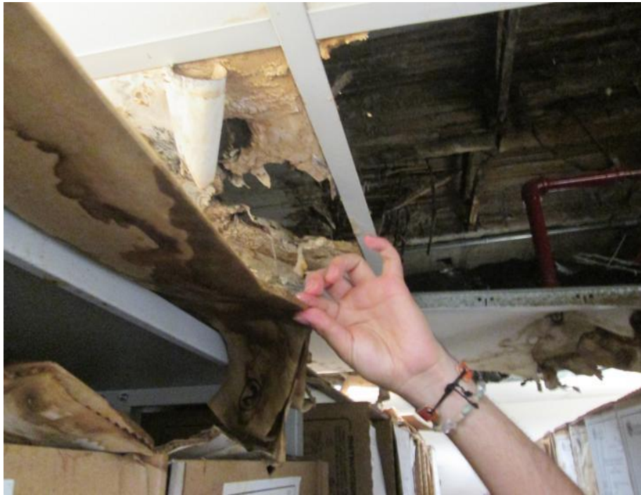
Ilustración 5. Deterioro del techo en el Archivo Central
