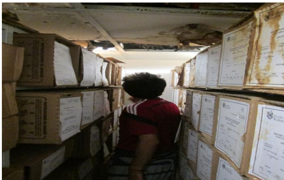
Ilustración 6. Panorámica del deterioro del techo y las cajas de conservación expuestas a la humedad
