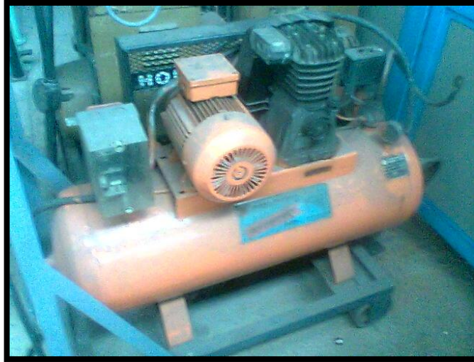
Figura 27. Compresor área de soldadura
