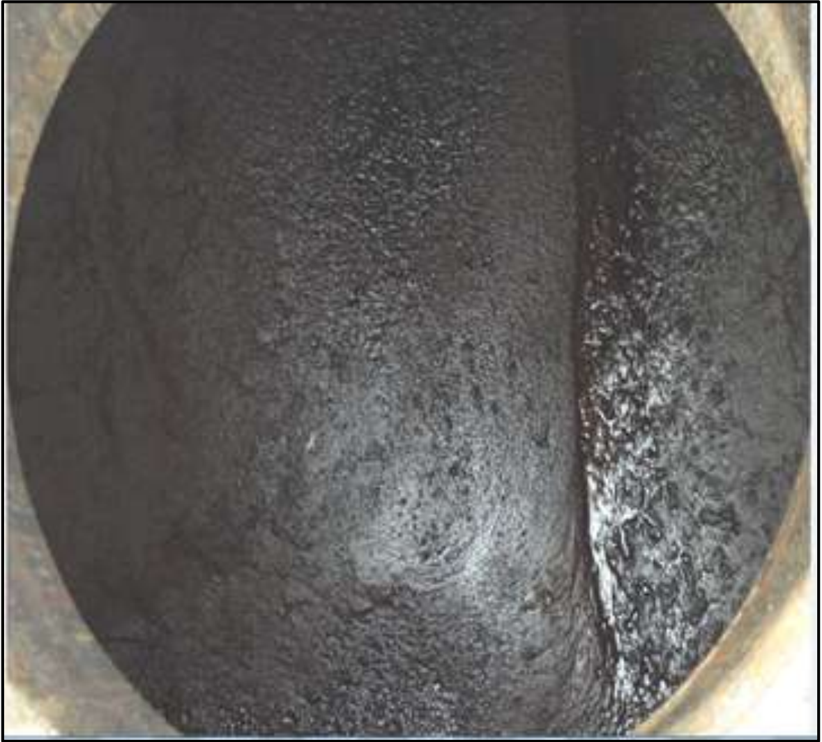
Figura 8. Parte interna de un Separador saturado de arena.
