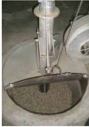
Foto 7. Elevador de aire.
