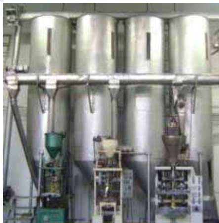
Foto 11. Silos de desgasificación.
