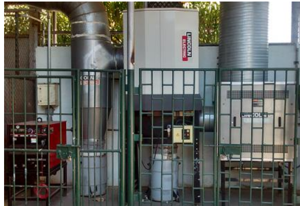
Figura 28. Extractor de humo fijo Lincoln
