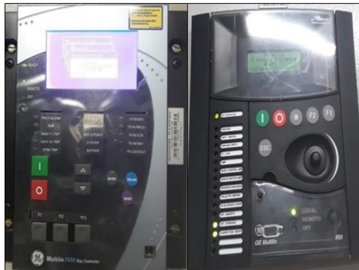
Figura 13. Relés controladores de los Interruptores presentes en el sistema.
