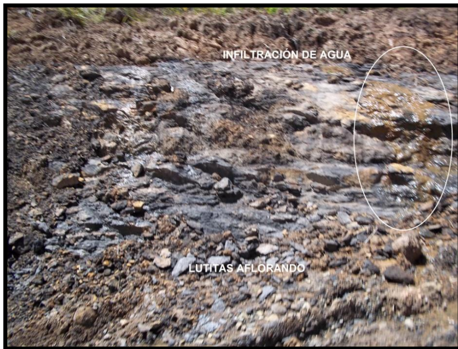
Ilustración 10. Evidencia de infiltración de agua en el coluvión.
