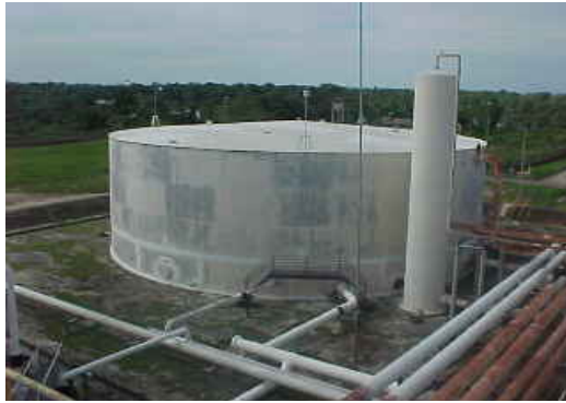
Foto 2. Tanque de tratamiento FWKO de 100000 Bbl de capacidad
