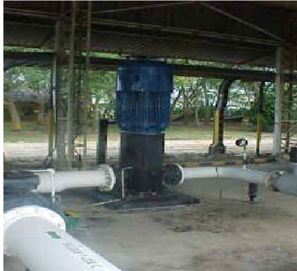
Foto 6. Bombas de transferencia de los tanques de almacenamiento
