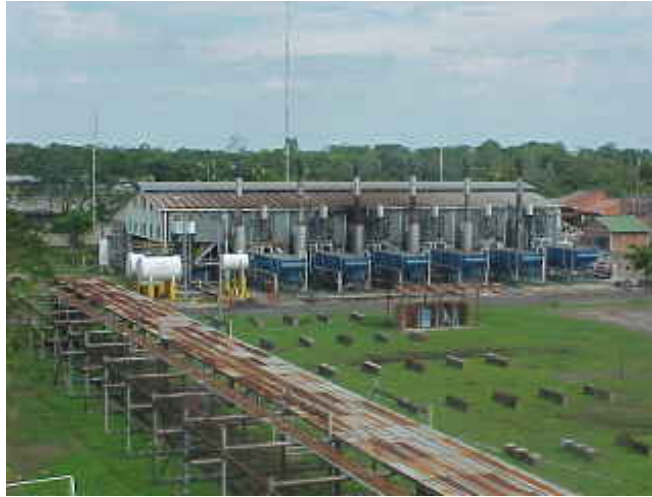
Foto 12. Estación de bombeo PS1
