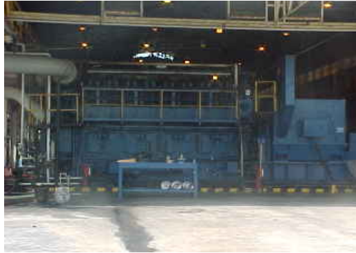
Foto 15. Motor de la planta de fuerza.
