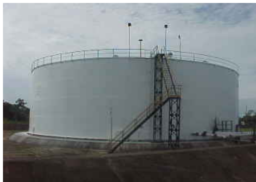
Foto 5. Tanques de almacenamiento de capacidad 100000 Bbl
