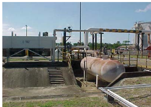
Foto 3. Sistema de gas condensado
