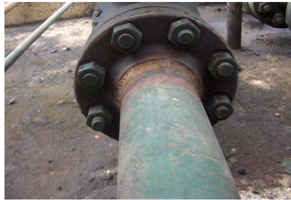
Fig. 13 Brida y línea de conducción de 6" x 300 Psi.
