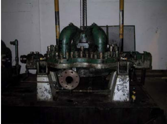
Fig. 10 Unidad de bombeo de maquina compresora
