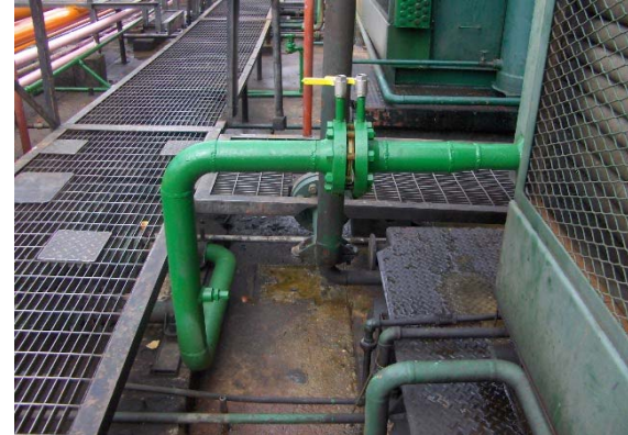
Fig. 11 Línea de conducción de vapor
