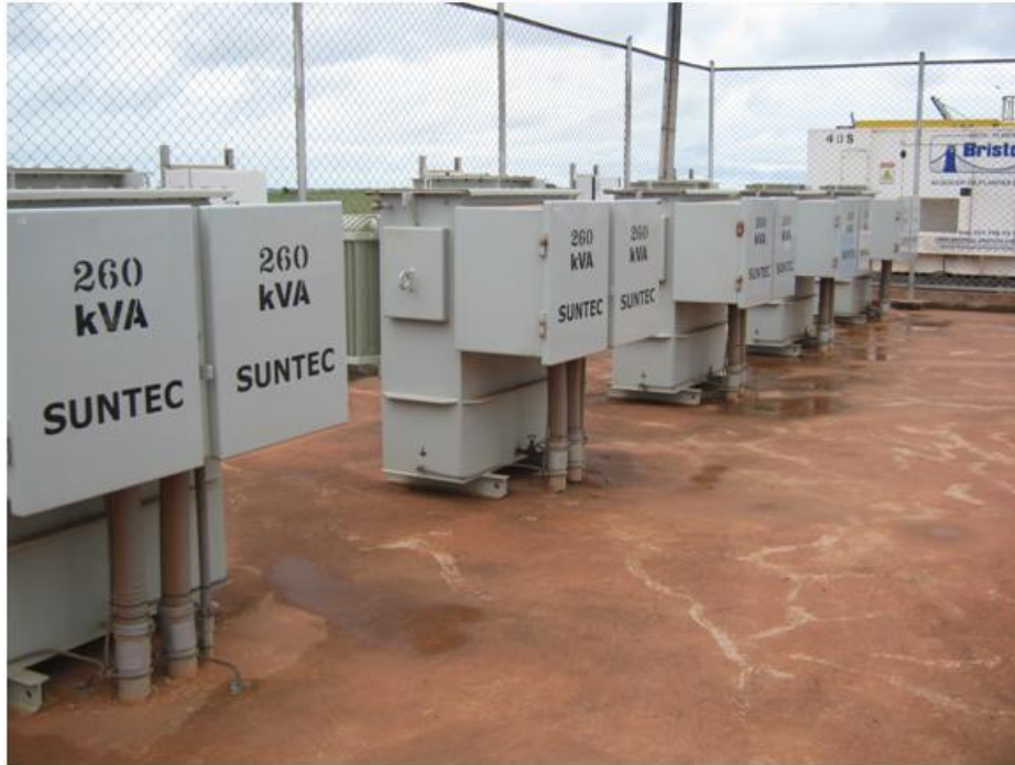
Figura 18. Transformadores de Sistema BES
