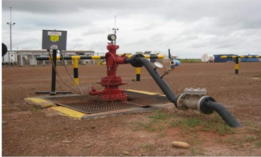
Figura 16. Cabezal de Pozo Sistema BES
