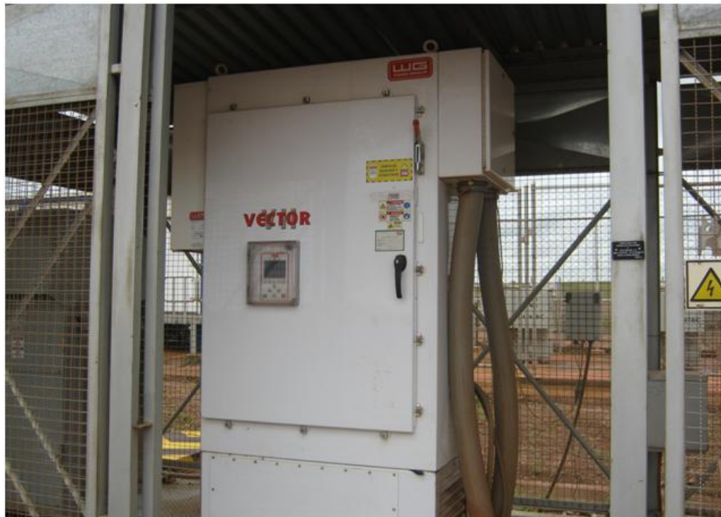
Figura 17. Controlador de voltaje sistema BES
