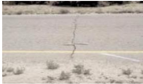
Figura 2. Agrietamiento por baja temperatura [2]
