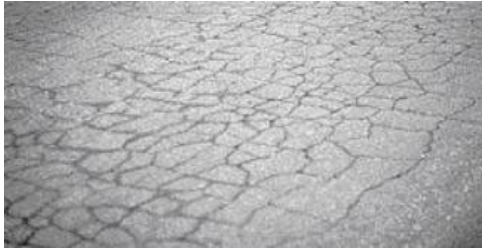
Figura 1. Fisuración por fatiga [2]
