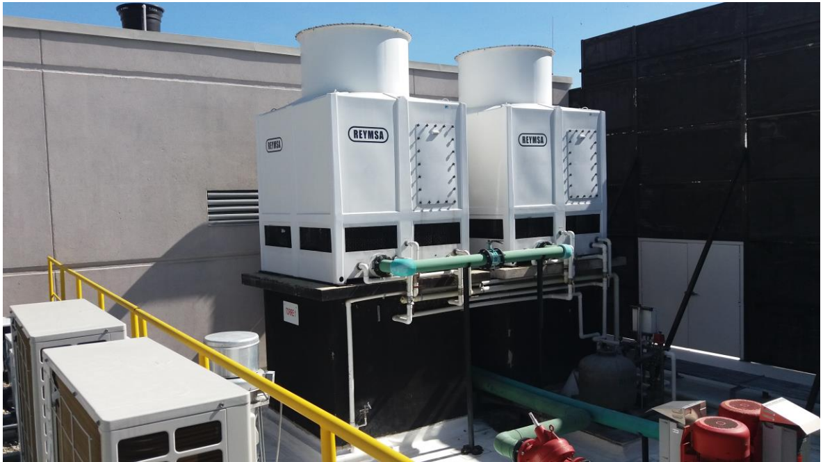
Figura 2. Torre de Enfriamiento 1. Parque Caracolí
