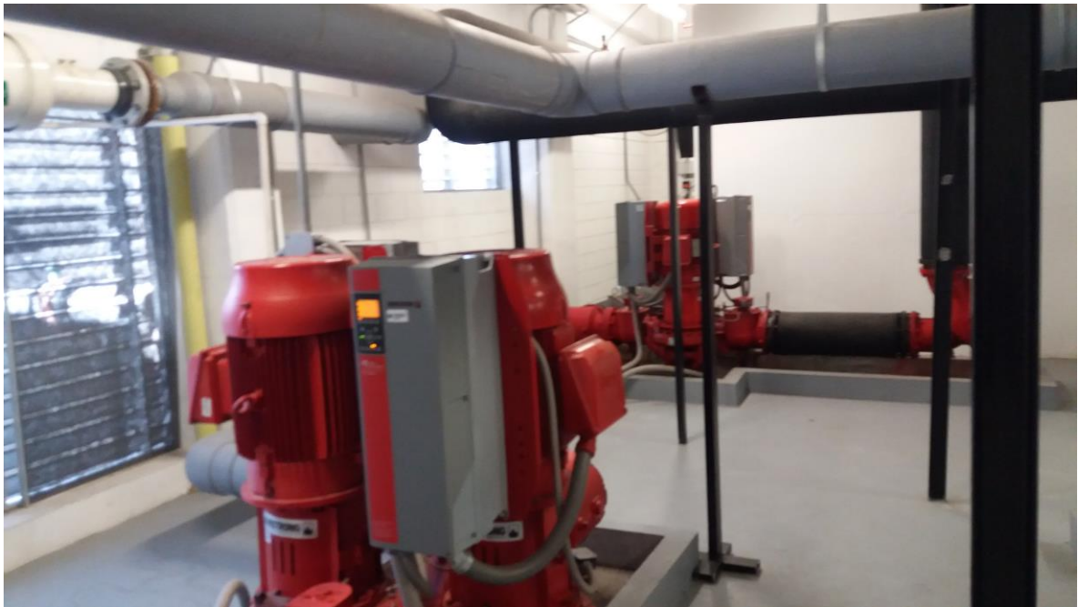
Figura 3. Bombas Centrífugas Parque Caracolí
