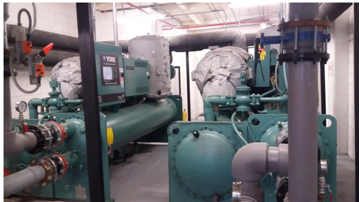
Figura 1. Chillers Parque Caracolí
