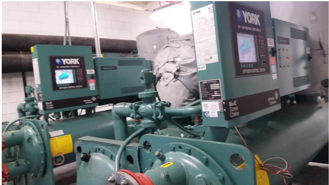
Figura 44. Chillers 1 y 2 Parque Caracolí
