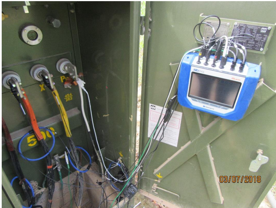
Figura 25. Analizador instalado en el transformador de Industrias Pacecol S.A.S.
