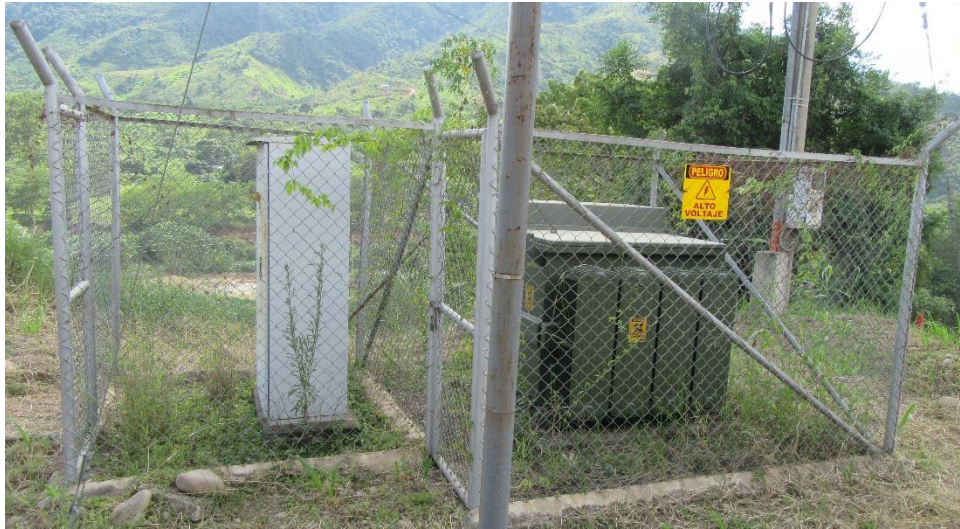
Figura 19. Transformador del cliente Industrial Pacecol
