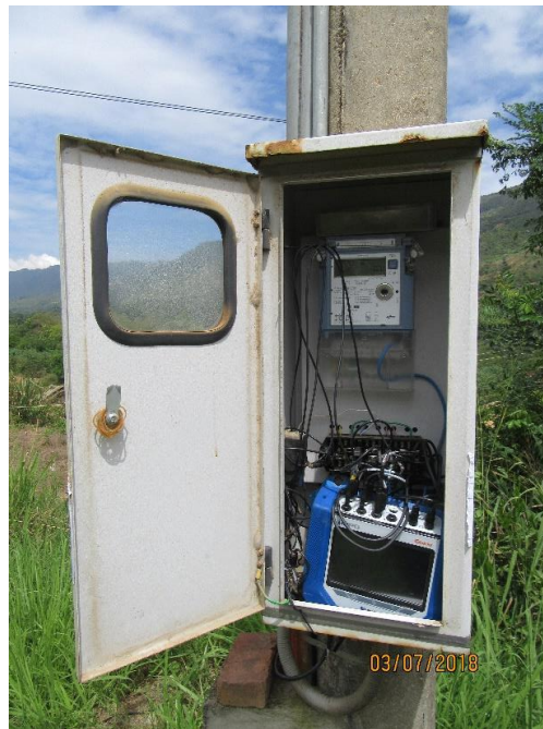
Figura 24. Analizador instalado en el medidor de energía eléctrica #50851249 de Industrias Pacecol S.A.S.
