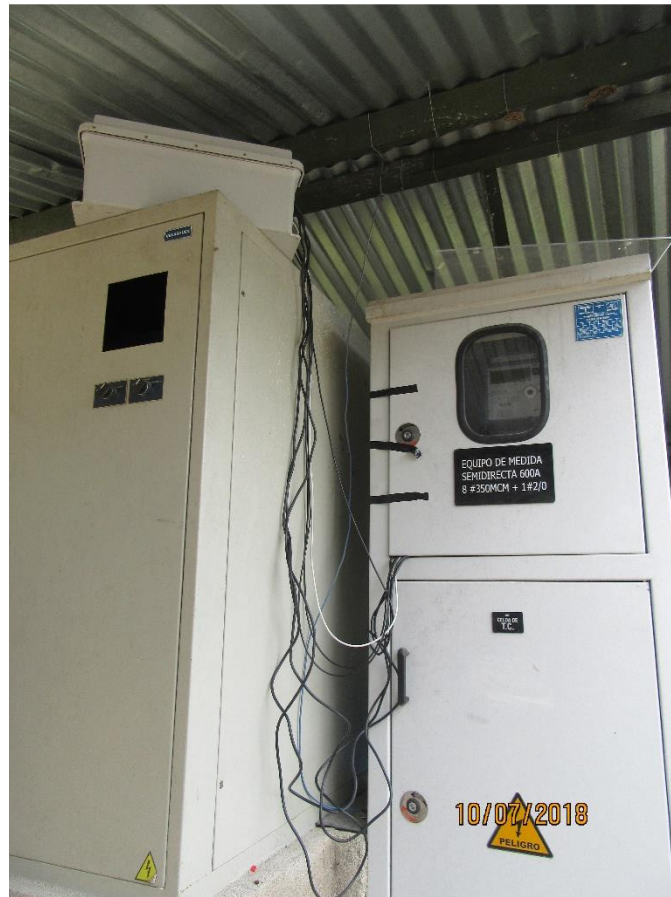
Figura 26. Analizador instalado en el medidor #37644741 de Beltran Garafo Lucelina
