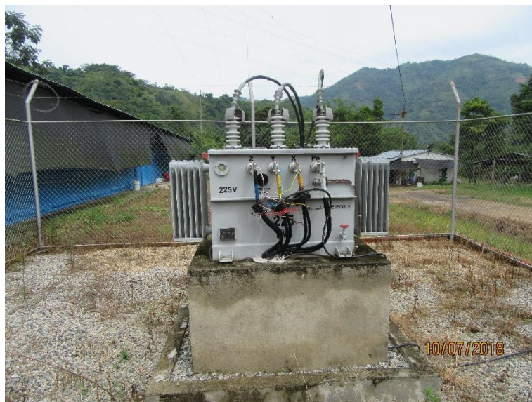
Figura 21. Transformador del cliente Beltran Garafo Lucelina
