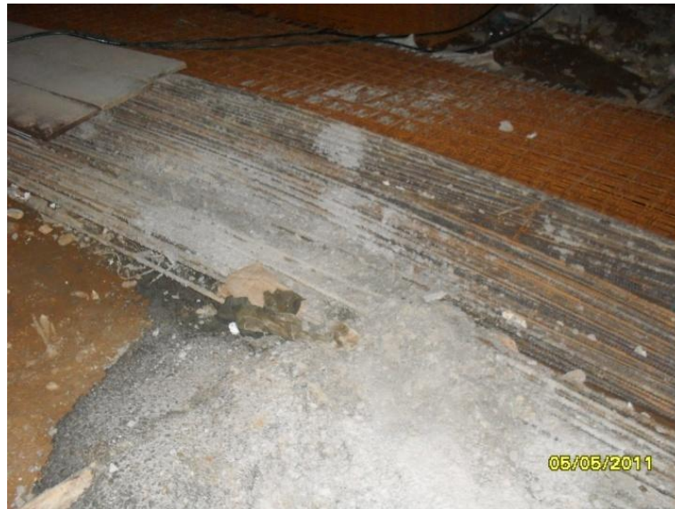
Figura 4-7. Deterioro de Materiales en el PROYECTO
