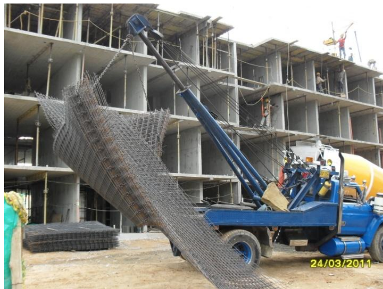
Figura 4-4. Descargue incorrecto de material, causándole deterioro.
