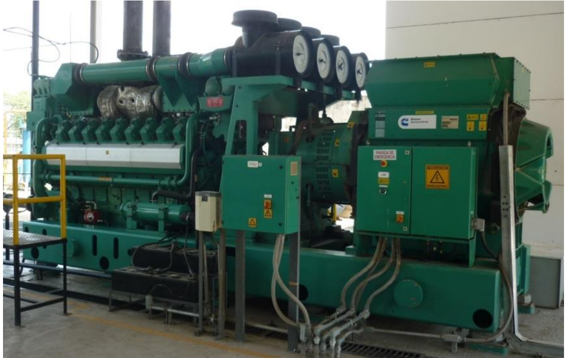
Figura 3. Moto-generadores CUMMINS de 1,75 MW.
