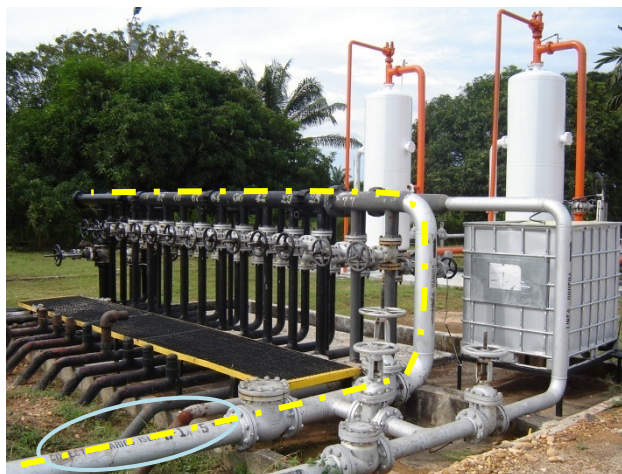
Figura 26. Línea principal colectora de crudo
