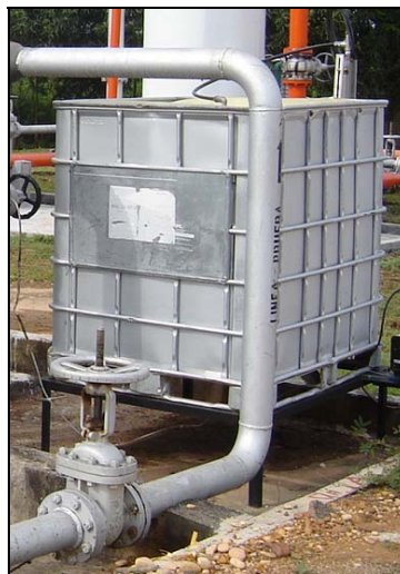
Figura 36. Sistema de inyección de químicos
