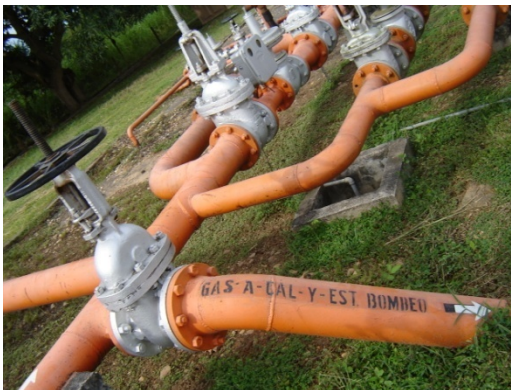
Figura 28. Línea de transporte de gas
