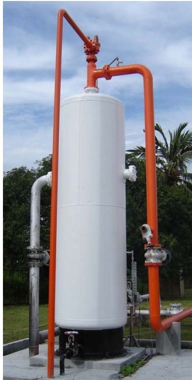
Figura 32. Separador general y de prueba
