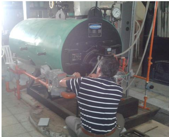
Figura 21. Fuente de alimentación (caldera)
