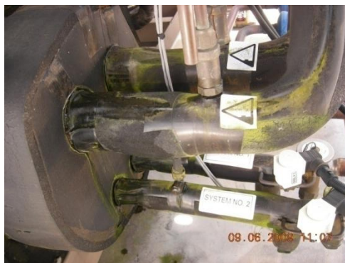
Conexiones de la tubería al evaporador
