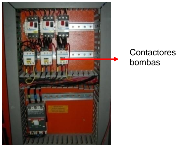
Figura 38. Breaker bombas de recirculación de agua
