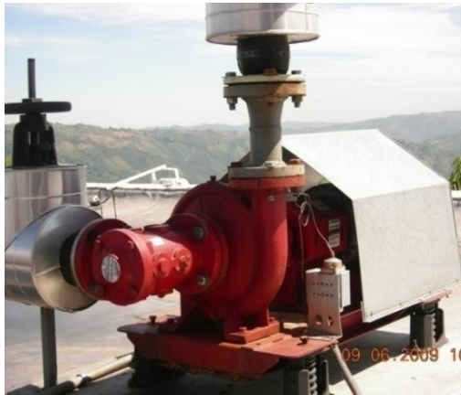
Figura 13. Bombas de recirculación de agua
