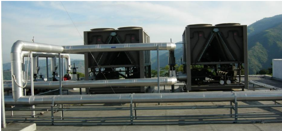
Figura 4. Unidades enfriadoras de agua
