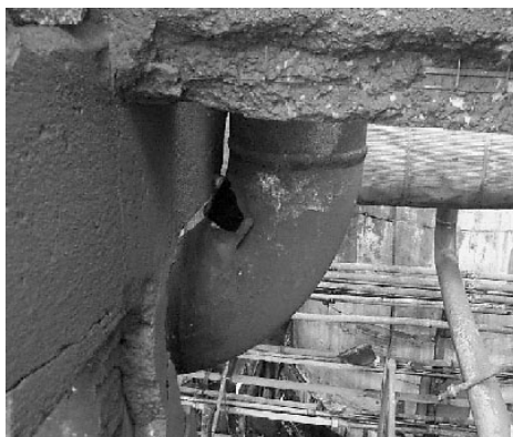
Figura 21. Falla por Sulfidación en codo de tubería 24
