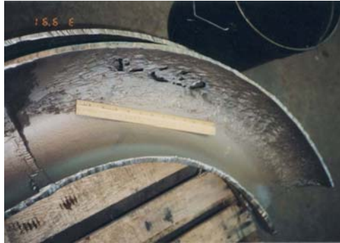
Figura 22. Corrosión – Erosión en un codo de 5 Cr debido a NAC 25
