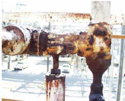
Figura 18. Presencia de CUI en una brida de CS 21
