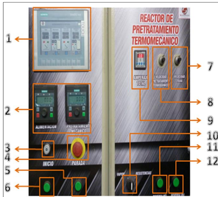
Figura 82: Tablero de control
