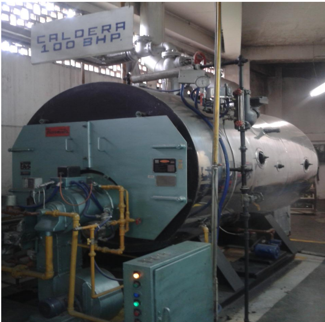
Figura 16. Caldera de 100 BHP, planta Dugotex.
