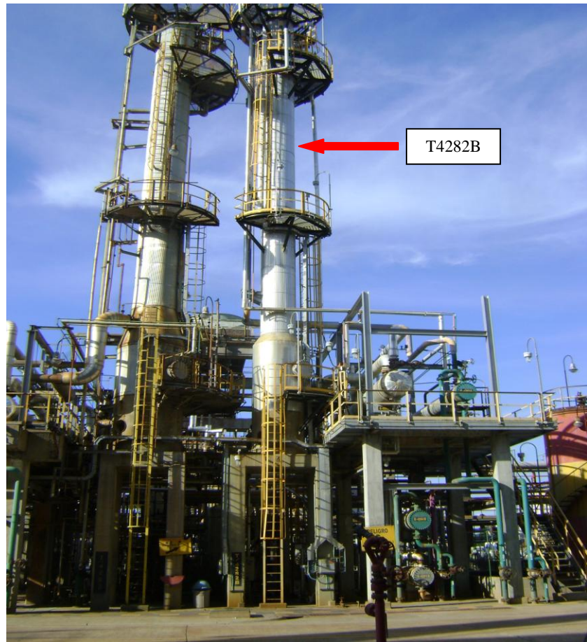
Figura 1. Columna despojadora T4282B
