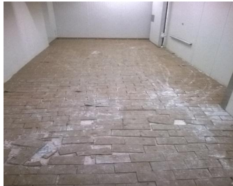
Figura 1. Estado inicial de los pisos.
