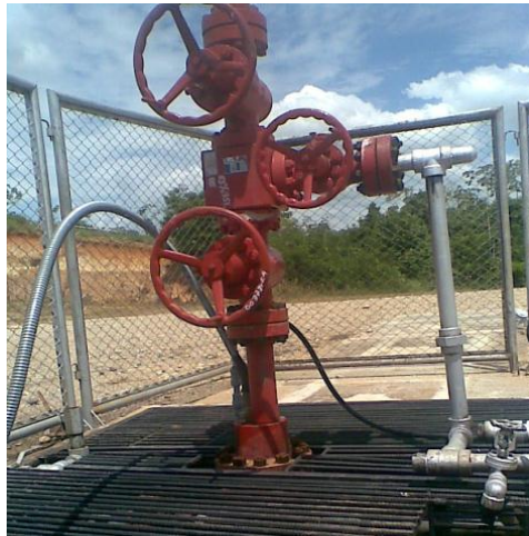
Figura 4. Cabezal de pozo con bombeo Electro – Sumergible
