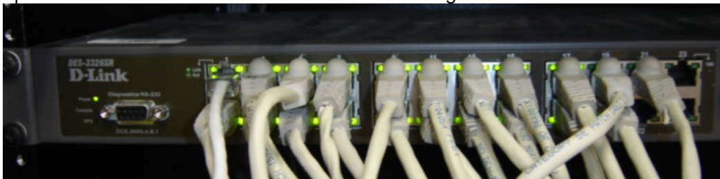
Figura 3. Panel frontal del Switch DES-3326.
