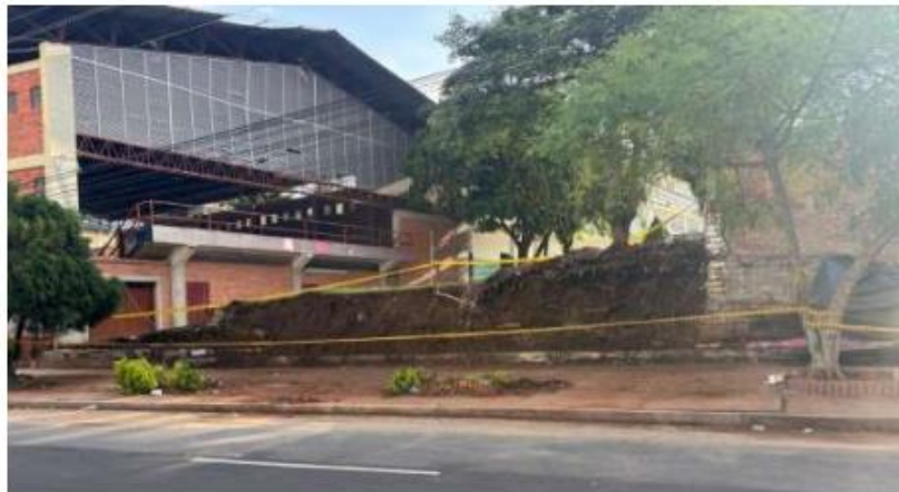
Figura 6. Falla muro en mampostería en el Colegio Santander, Bucaramanga.
