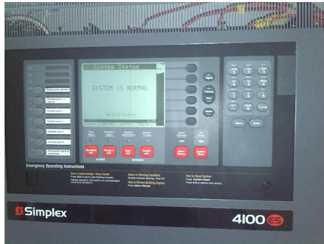
Figura 13. Panel de Incendio.
