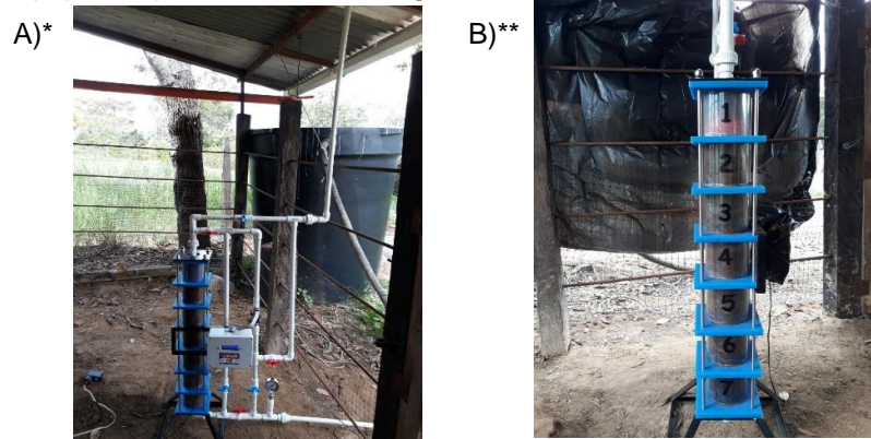
Figura 14. Equipo de purificación de biogás instalado en BDG finca Marcella.
