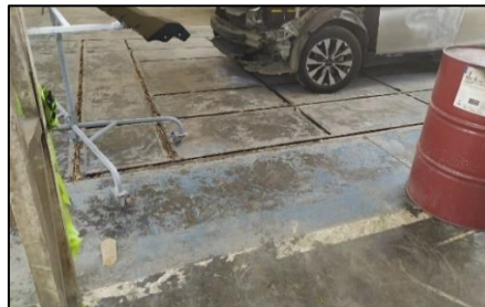
Figura 6. Fotografía taller PracoDidacol zona de anclaje y pintura, condiciones iniciales.
