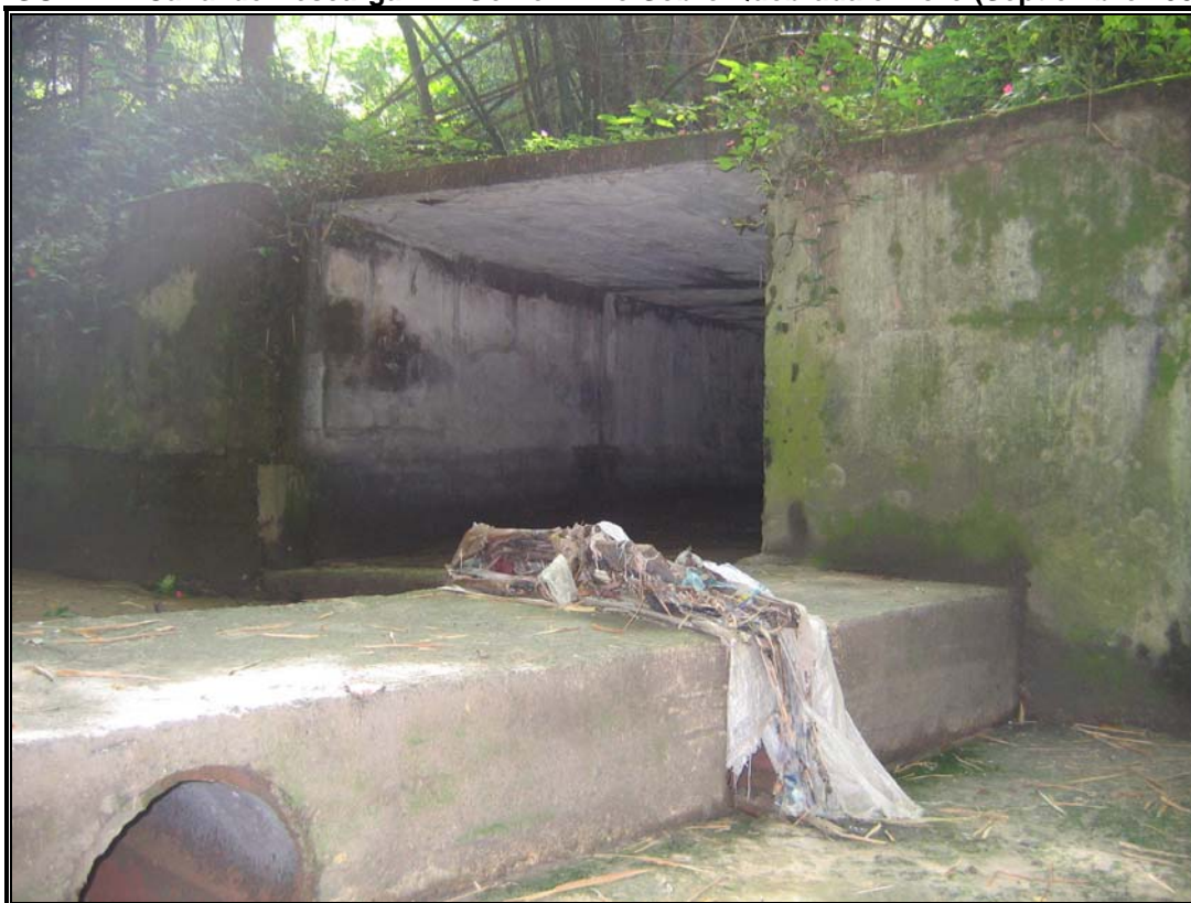
FIGURA 12 Canal de Descarga E-V Gómez Niño Sobre Quebrada el Loro (Septiembre 2005)
