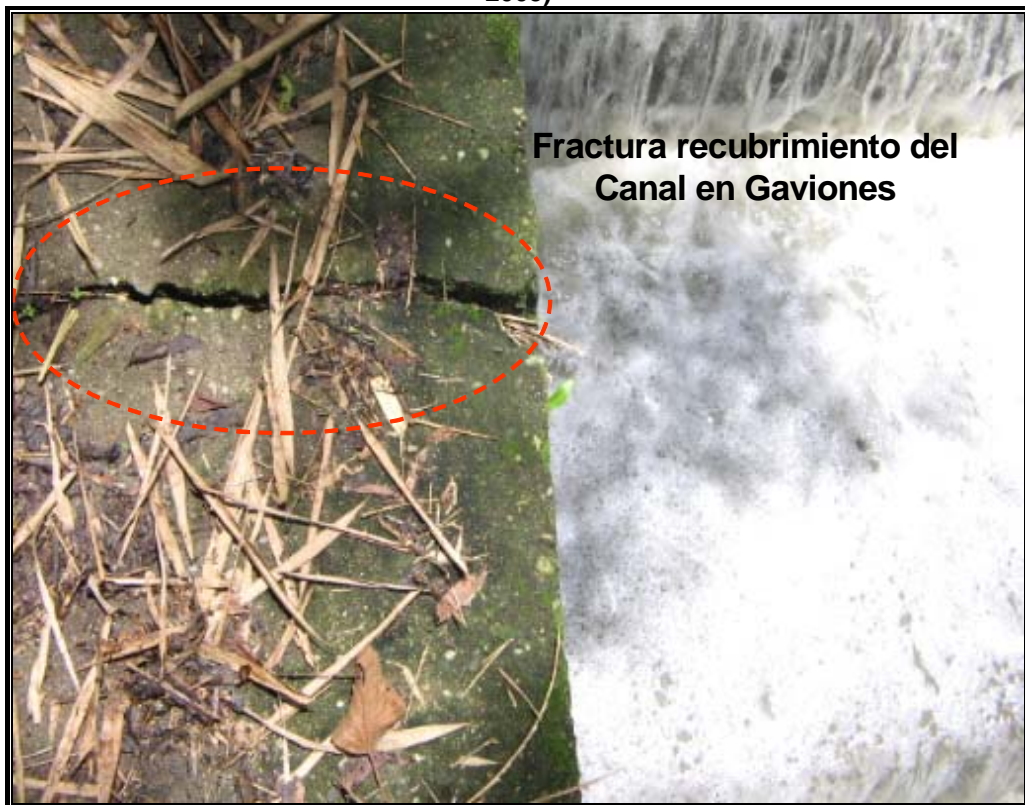
FIGURA 36 Fractura en el Recubrimiento del canal de descarga E-V San Miguel I (Septiembre 2005)
