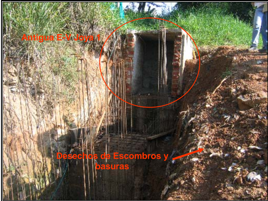
FIGURA 29 Desechos de escombros y basuras sobre los taludes laterales de la Estructura (Noviembre 2005)
