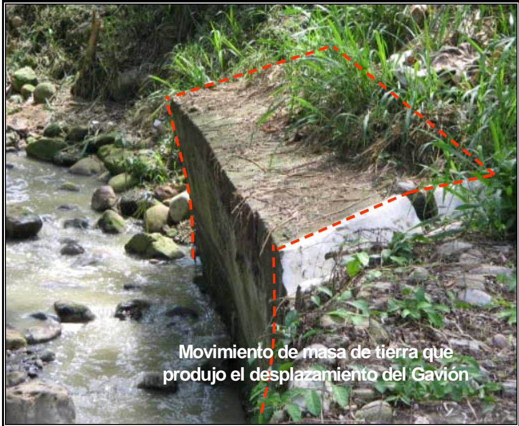
FIGURA 38 Movimiento de Masa que produjo el desplazamiento del Gavión del canal de descarga de la E-V Ciudadela (Septiembre 2005)
