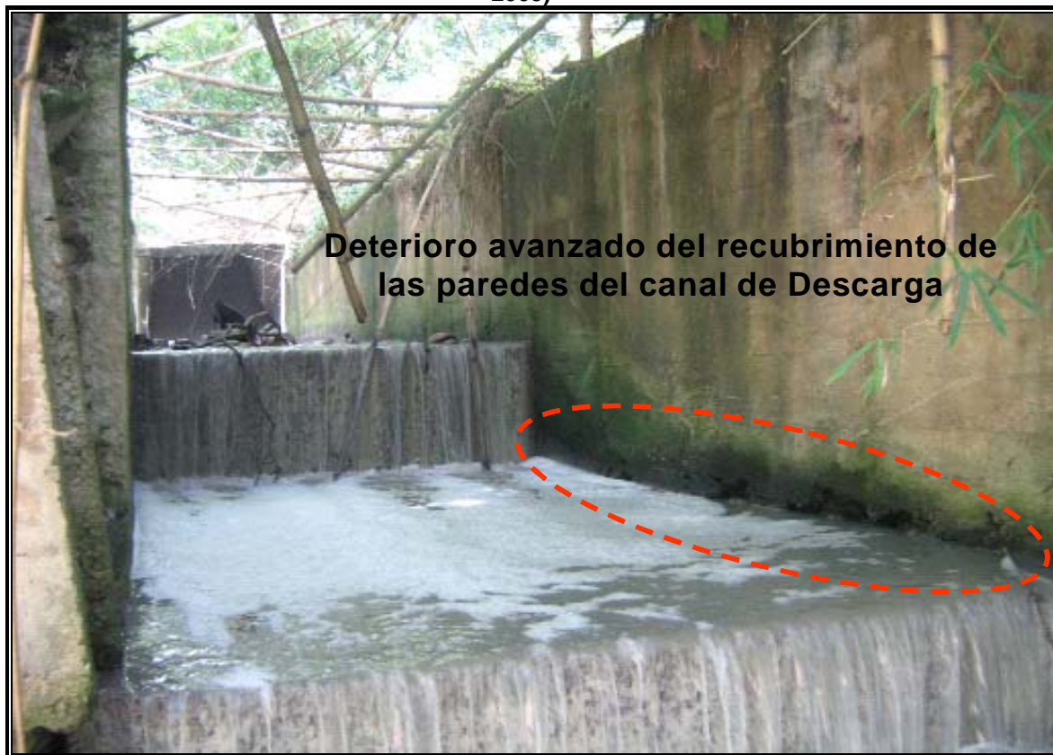
FIGURA 38 Deterioro de las paredes del canal de entrega de la E-V Barrio Mutis (Septiembre 2005)
