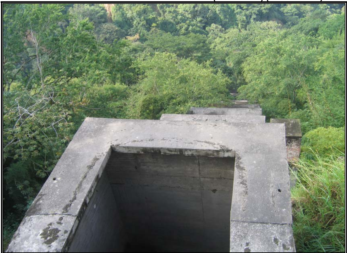
FIGURA 5 Estructura de Vertimiento Calle Sexta (Escalonada) (Octubre 2005)
