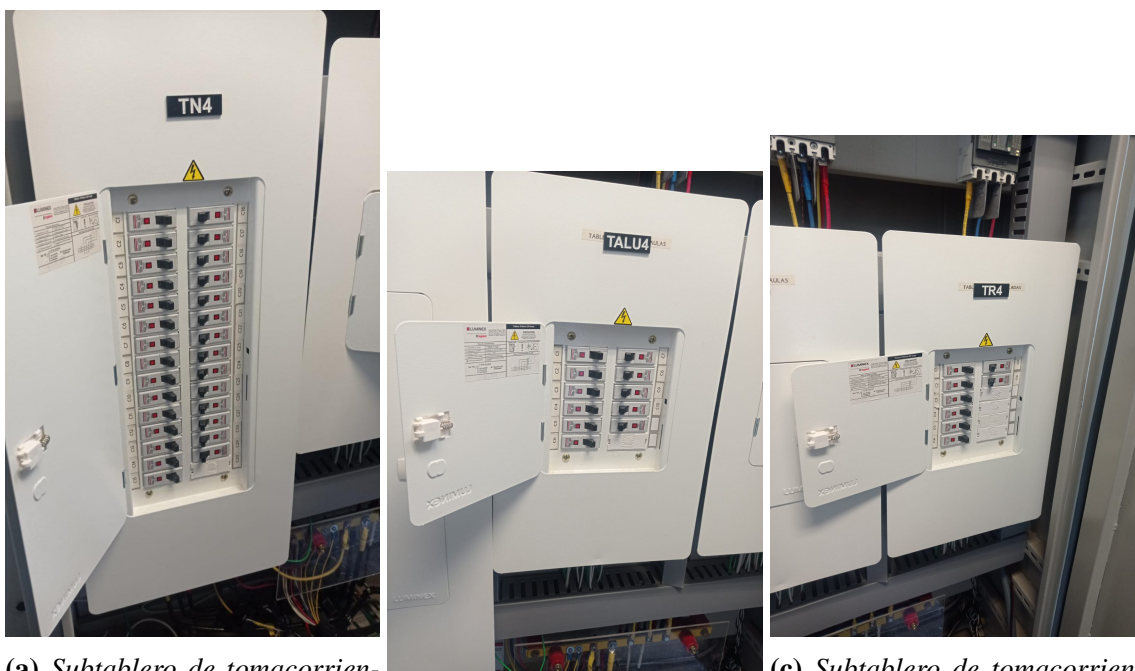
(a) Subtablero de tomacorrientes normales.
