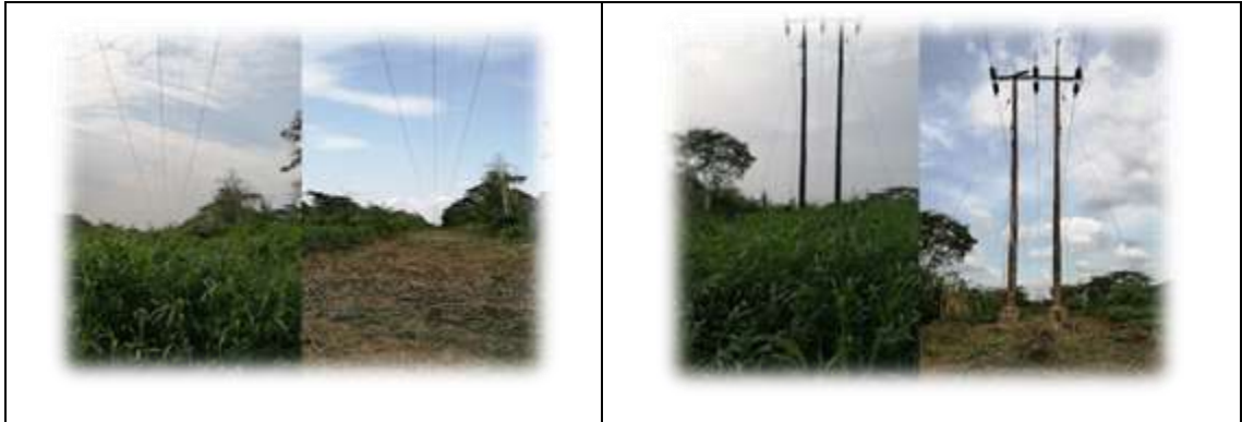
Fuente. Informe de gestión área técnica 2020 ENELAR ESP.
