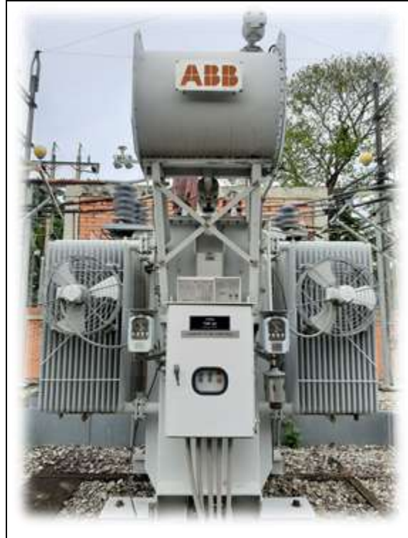
Figura 20. Transformadores de potencia de 10 MVA.
