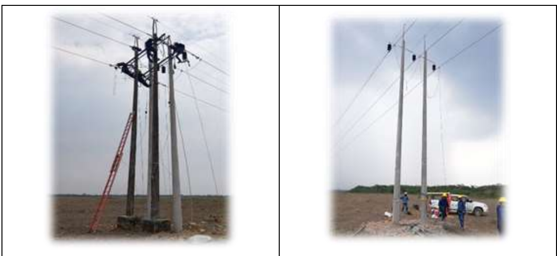
Fuente. Informe de gestión área técnica 2020 ENELAR ESP.
