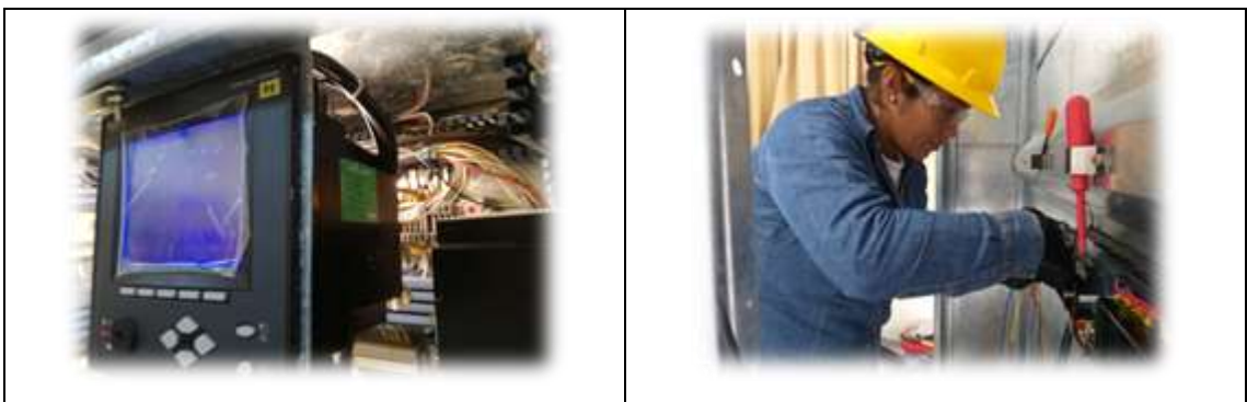
Fuente. Informe de gestión área técnica 2020 ENELAR ESP.
