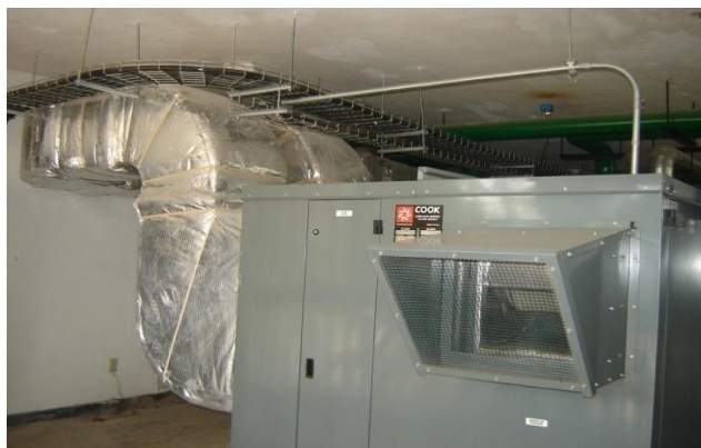
Figura 22. Aire acondicionado biblioteca – UIS
