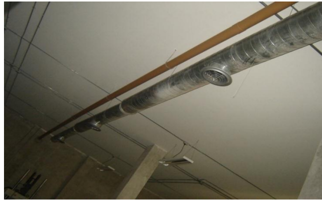
Figura 11. Aires acondicionados - laboratorio de Civil
