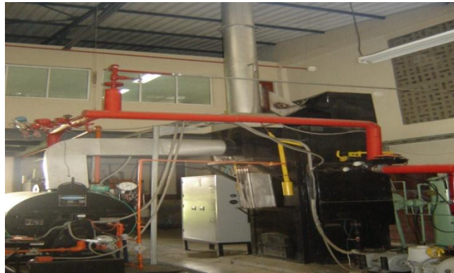
Figura 15. Laboratorio de transferencia de calor – Mecánica
